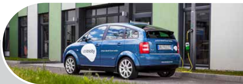
Die Systemsteckdose kann in die Mastklappe oder direkt in den Beleuchtungsmasten integriert werden © ubitricity
